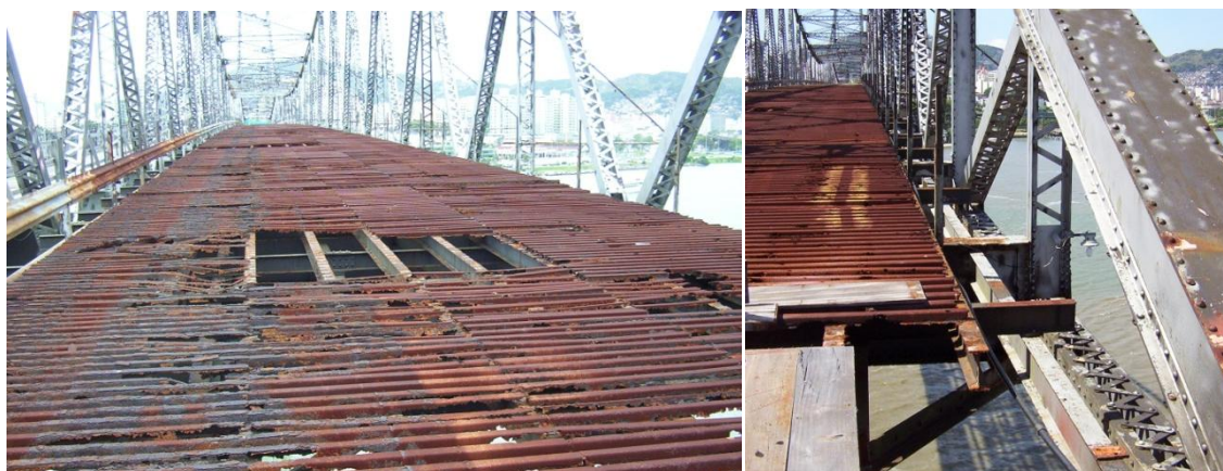
Figura 7: Elevado estágio de corrosão do tabuleiro metálico.
