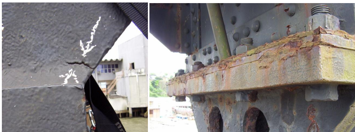
Figura 6: Fissuras e elevado estágio de corrosão das bases dos pilões.
