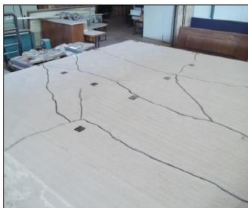
Figura 4.2 - Trincas na laje que foram preenchidas com graute epóxi fluido (Campuzano, 2016).
