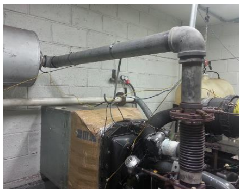
Figura 1. Duto de exaustão
