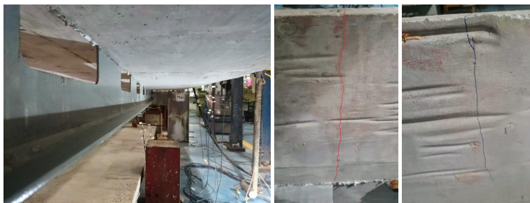
Figura 16. Configuração do protótipo após o ensaio e fissuras na laje de concreto
