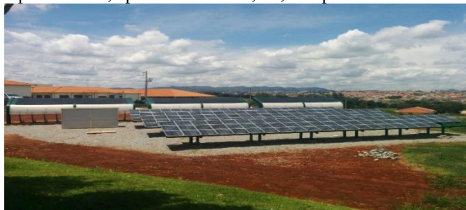
Fig. 1 - Pequena usina de geração fotovoltaica da UFLA.
