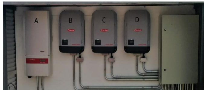
Fig. 3 - Inversores de conexão com a rede elétrica utilizados no sistema em análise.
