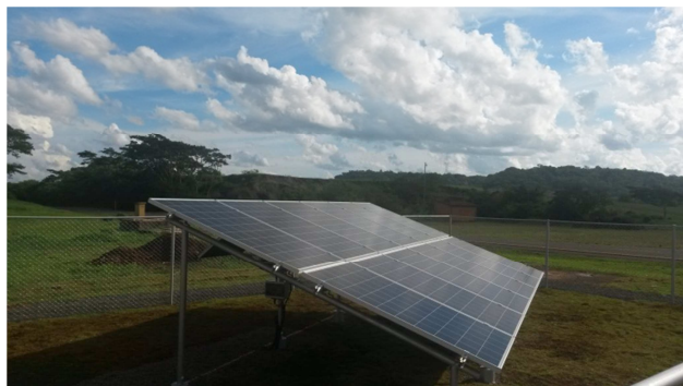
Fig. 3. Sistema de geração de energia solar fotovoltaica. Instalação em Itaipu Binacional.
