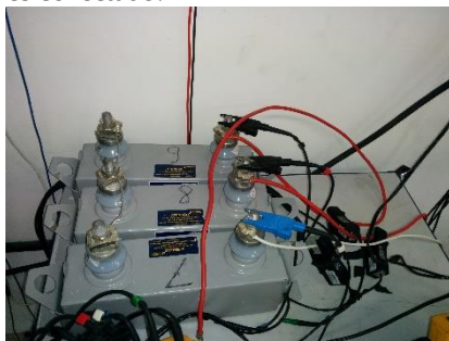
Fig. 7. Detalhe da ponte retificadora e do capacitor eletrolítico utilizado na carga.
