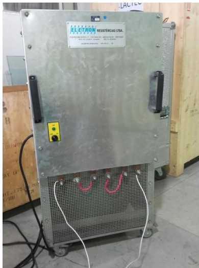
Fig. 6. Banco de resistências 3x10kW.
