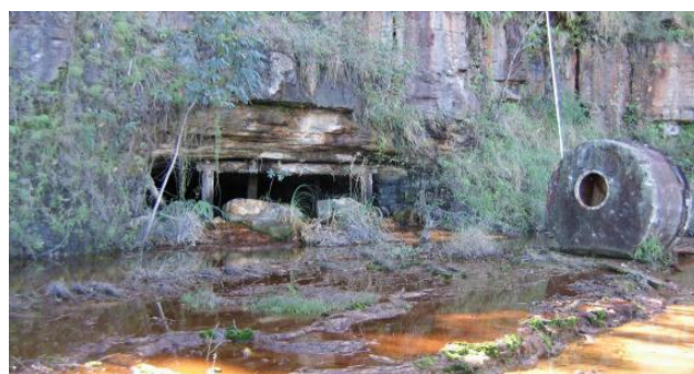
Figura 5: Boca de mina abandonada
