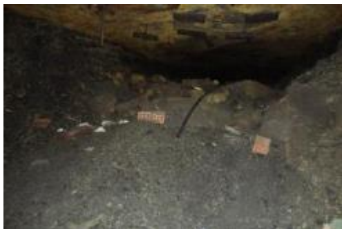
Figura 16 – Galeria com material de caimento acumulado.
