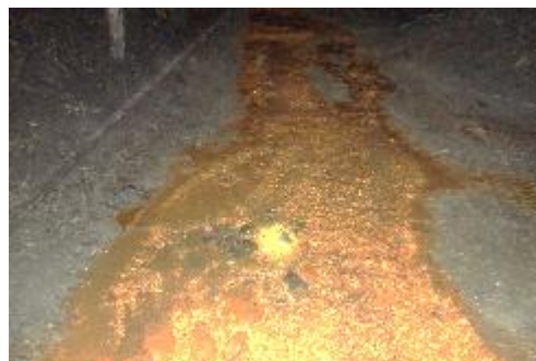
Figura 15 – Fluxo de água oriunda da barragem do bloco norte em sentido sul.
