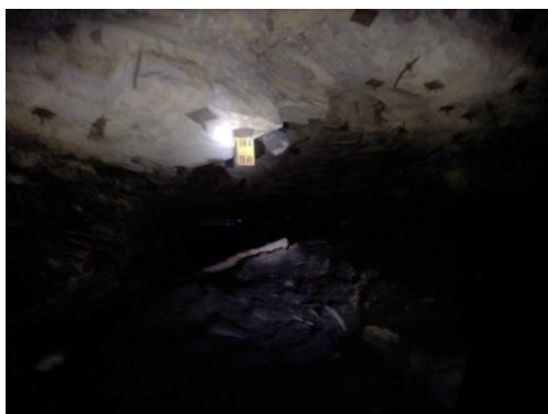
Figura 13 - A sinalização de subsolo não estava de acordo com o exigido pelas normas de segurança.
