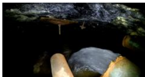
Figura 14 – Barragem que integrava o sistema de drenagem de subsolo da UM II – Verdinho.
