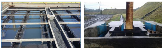
Figura 05 - Superfície dos decantadores mostrando os vertedouros de esgotamento e as calhas Parshall de medição da vazão do overflow clarificado.
