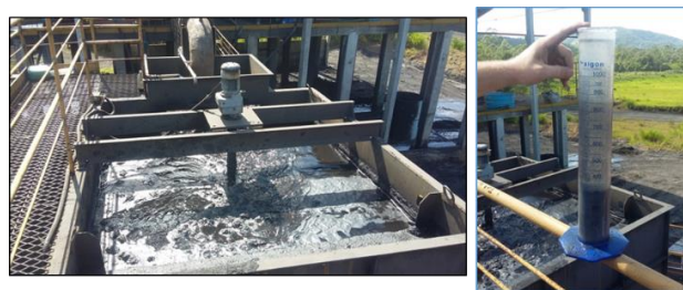
Figura 03 - Tanque de condicionamento da polpa com floculantes.
