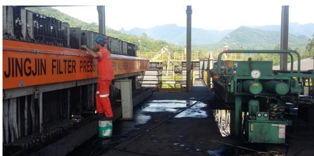
Figura 04- Filtros prensa equipado com placas de 2 x 2 m e 1 x 1 m.
