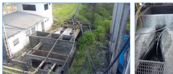
Figura 02 – Calhas Parshall para medição da vazão de alimentação dos espessadores..
