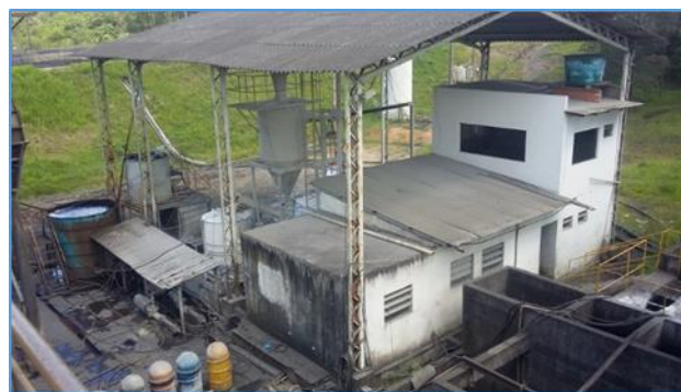
Figura 06 – Sistema de preparação do leite de cal e solução floculante.
