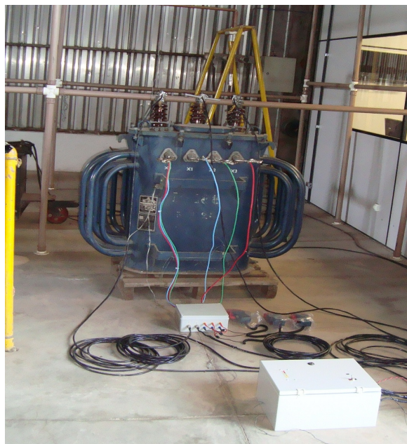
Figura 10: Foto de ensaio realizado em campo com transformador de 112,5 kVA 13,8 kV - 220/127 V em perfeito estado de funcionamento
