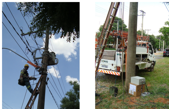
Figura 11: Foto de ensaio realizado em campo com transformador com falha de isolamento cuja potência nominal é de 75 kVA e tensão de 13,8 kV - 220/127 V
