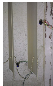
Figura 8: Sensores ópticos instalados
