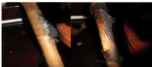
Figura 6. Condutor com avaria do transformador avaliado.
