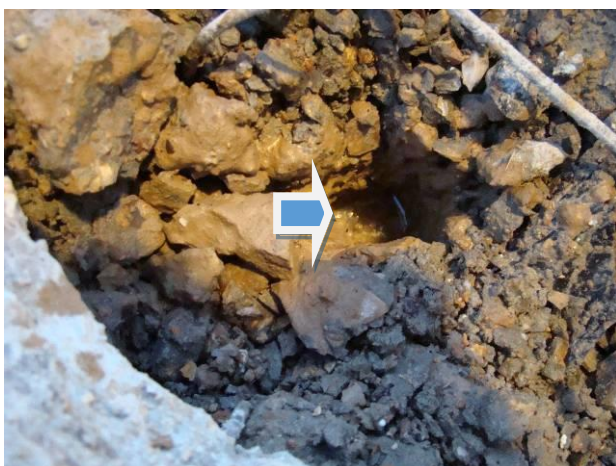
Figura 7. Água acumulada sob o piso da caldeira.
