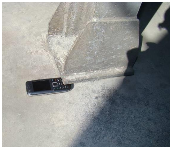
Figura 2. Bloco com recalque, estrutura livre.
