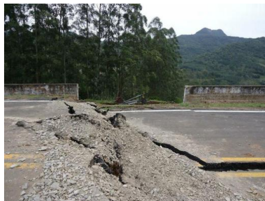
Figura 2. Danos na rodovia ERS-115 devido a ruptura de cortina atirantada. (MPRS, 2013)
