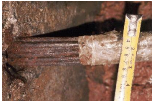
Figura 1. Detalhe do tirante com corrosão acentuada (Pitta et al. , 2006)
