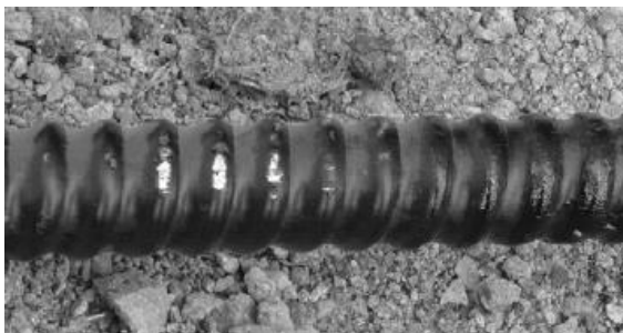
Figura 4. Perda de lascas da camada de Epoxy. (Irvin e Mothersille, 2007)
