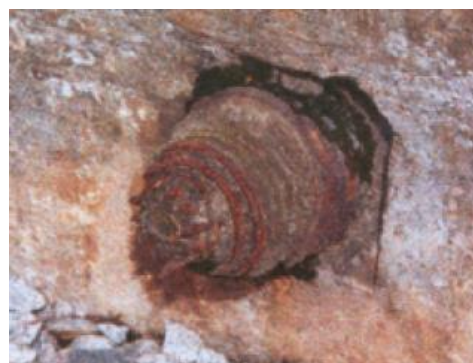
Figura 7. Cabeça do tirante em processo de corrosão (Solotrat, 2015)
