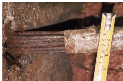
Figura 3. Detalhe do tirante com corrosão acentuada. (Pitta et al , 2006)
