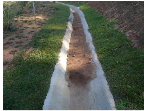
Figura 6. Obstrução da canaleta
