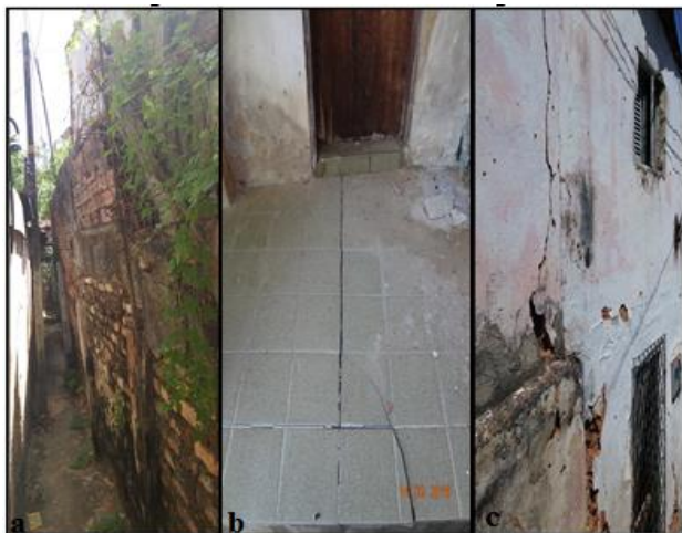
Figura 4. Feições de instabilidade encontradas em São José do Jacó. a) Muro curvado; b) Fissuras e afundamento do piso; c) Fissuras na alvenaria da casa;
