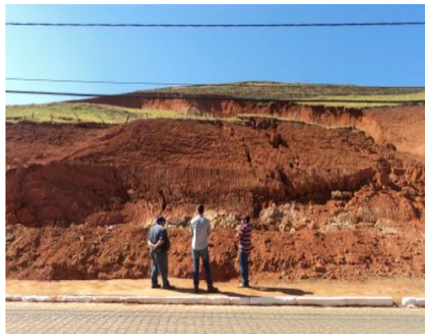
Figura 2. Vista de jusante para montante do corte, com detalhe para os deslizamentos ocorridos.
