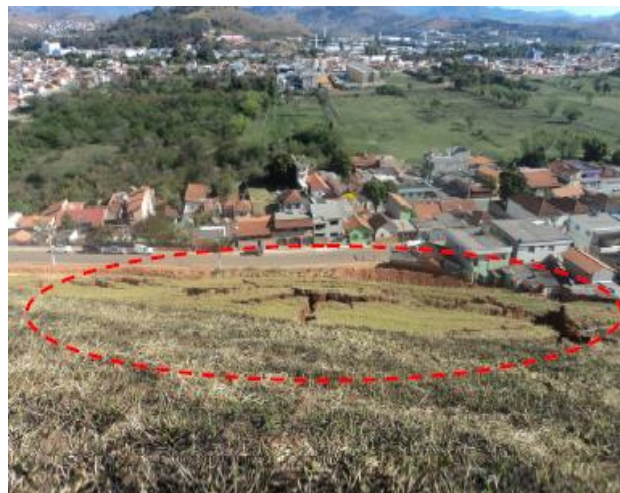
Figura 3. Trincas de tração observadas no maciço, vista de montante para jusante.
