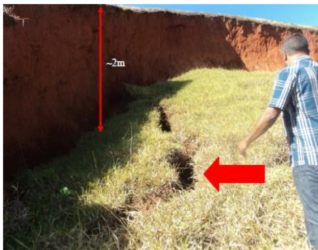
Figura 4. Vista interna da massa rompida, com destaque para a magnitude das trincas.
