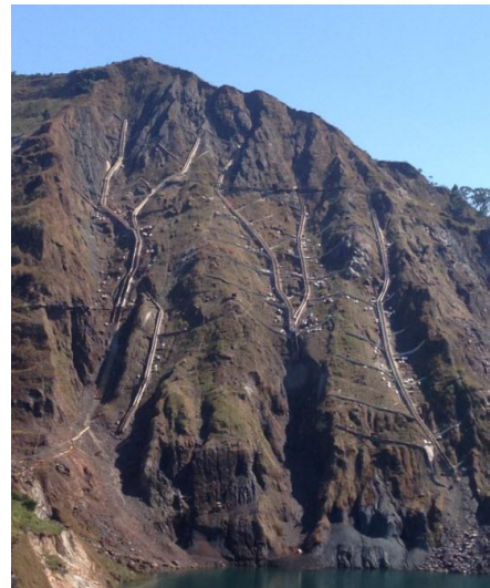
Figura 6: Condição atual do sistema de drenagem
