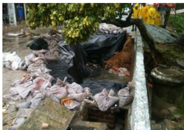
Figura 7. Rua Guanabara no dia 13/06/14 após o primeiro movimento. Cicatriz do movimento comprometendo aproximadamente 40% da largura da Rua.
