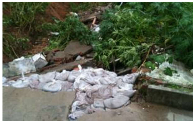
Figura 10. Vista da colocação dos sacos de areia e da tubulação de esgoto na cor alaranjada exposta.
