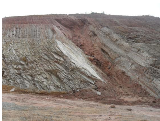
Figura 7. Ruptura no talude do Corte 119.
