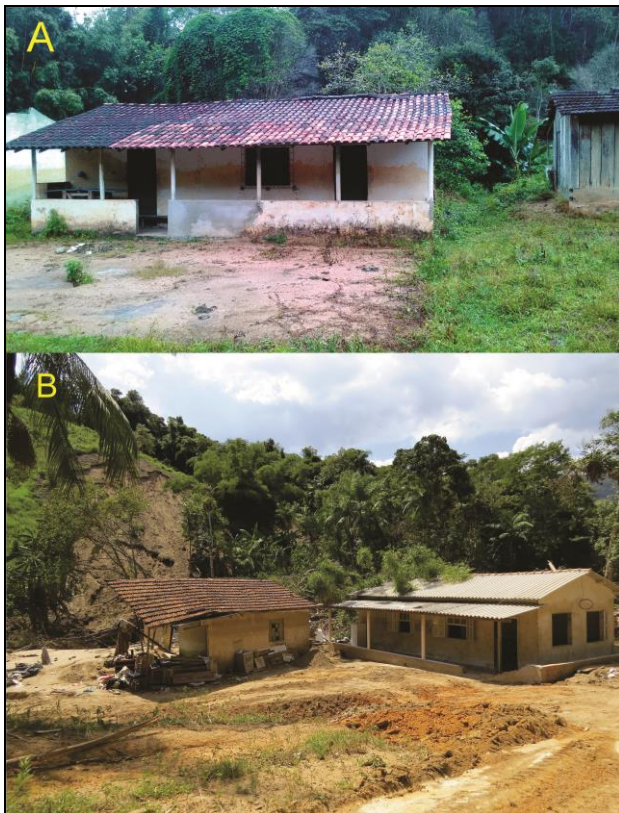
Figura 1. A foto A mostra a marca da água causada pelo fluxo de lama, atingindo a altura das janelas e portas. A foto B apresenta uma cicatriz de deslizamento de terra em uma encosta removendo solo e material vegetal (Fonte: Sirden / CTGeo / IPT, 2014).
