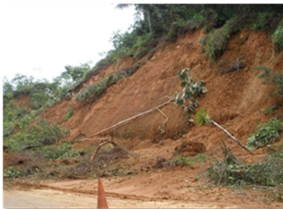
Figura 7 – Ruptura “normal” no 2º segmento do talude.
