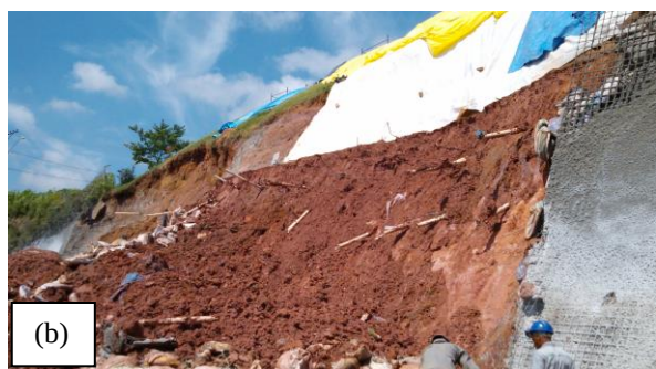
Figura 7:(a) Vista geral da sacaria para reconstituição do talude (b) escorregamento das sacarias após chuvas.
