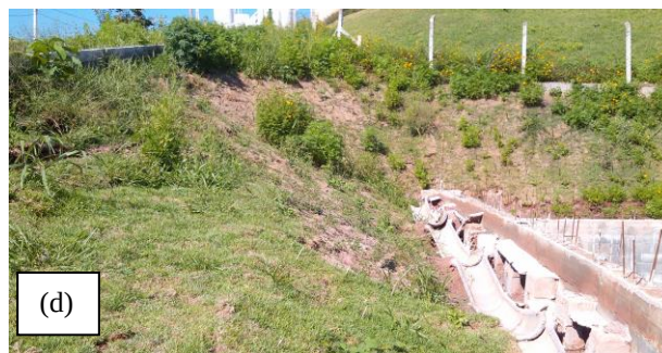
Figura 4: (a) indícios de tombamento e fissuras, (b) movimentação de 40 cm do muro em relação ao topo, (c) formação de trincas no aterro, (d) canaletas destruídas pela movimentação do muro permitindo entrada d' água.
