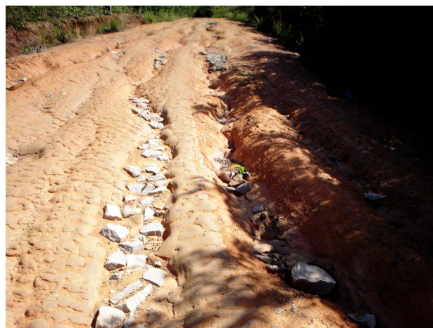
Figura 1. Exemplo de erosão na plataforma de uma das estradas existentes no PMAHC
