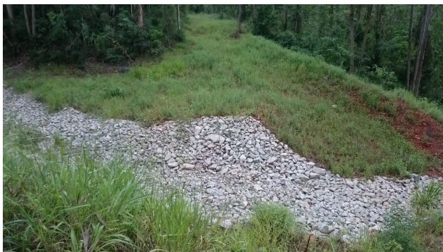
Figura 16. Vista da brecha na área da crista do Dique 12.
