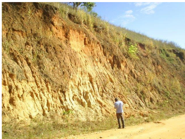
Figura 3: Talude de corte com erosão superficial.
