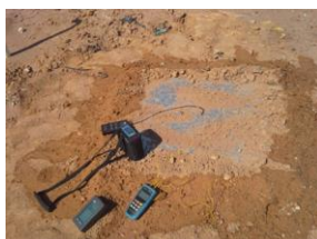
5.4. Placa selada e equipamentos instalados.
