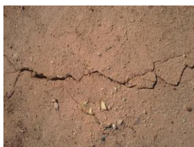
5.1. Local com fissura na camada barreira capilar.
