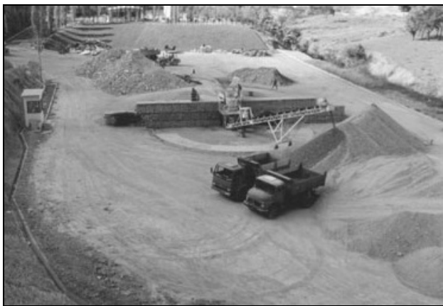
Figura 1. Usina de reciclagem de entulho. Fonte: Alterado de PBH, 2016.
