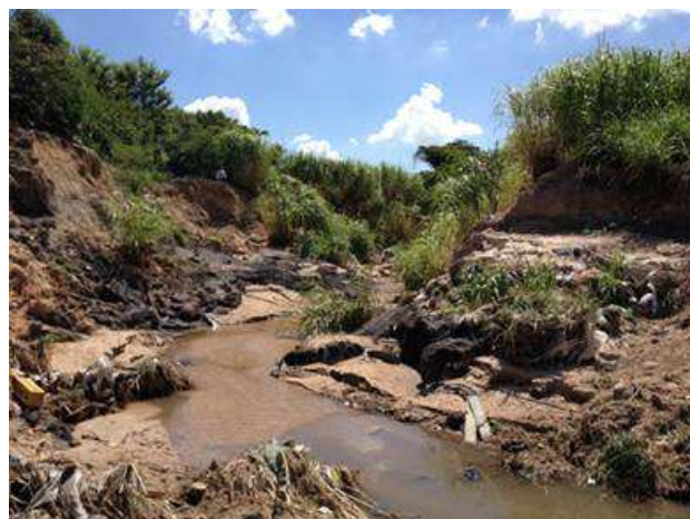
Figura 6 – Canal do riacho Jardim Novo Maracanã, após avanço de erosão regressiva pela seção inspecionada. Fonte: Acervo TBG (2015).
