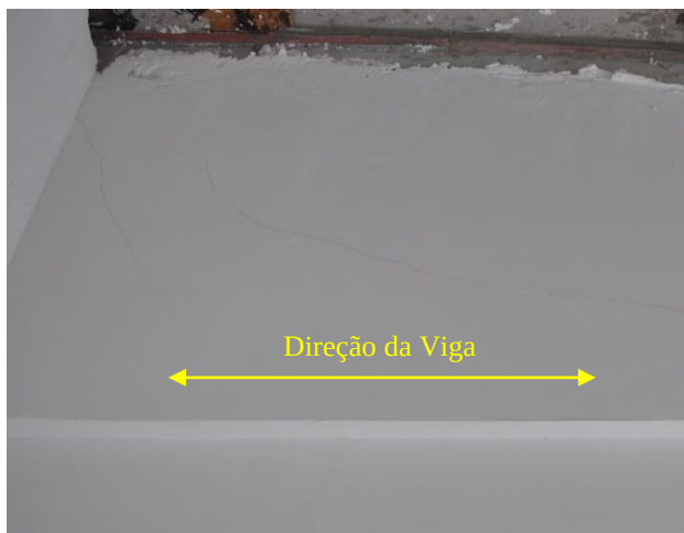
Figura 9 - Fissuras no Revestimento em Gesso da Viga
