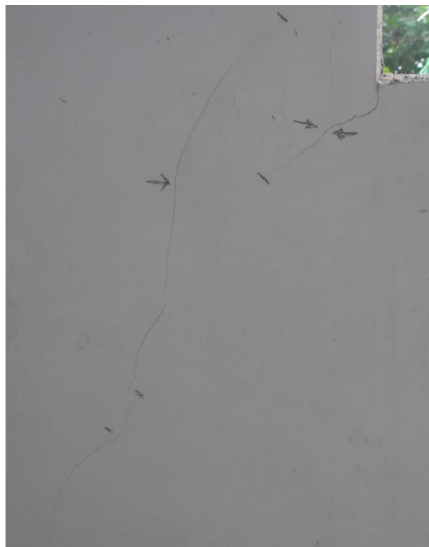
Figura 8 - Fissuras Próximas a Janela no Gesso
