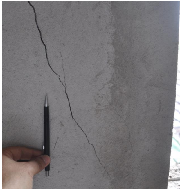
Figura 7 - Fissura Próxima a Janela no Emboço
