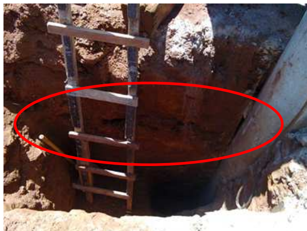
Figura 14. Ocorrência de camada de concreção de limonita durante a escavação na região de uma das estacas cravadas
