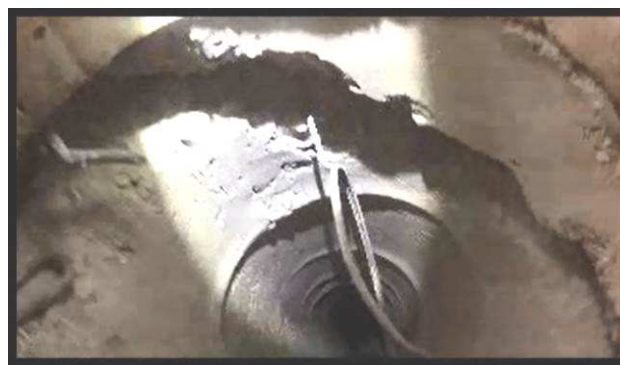
Figura 18. Dano significativo, na estaca PB03H, observada através de filmagem do interior da estaca.
