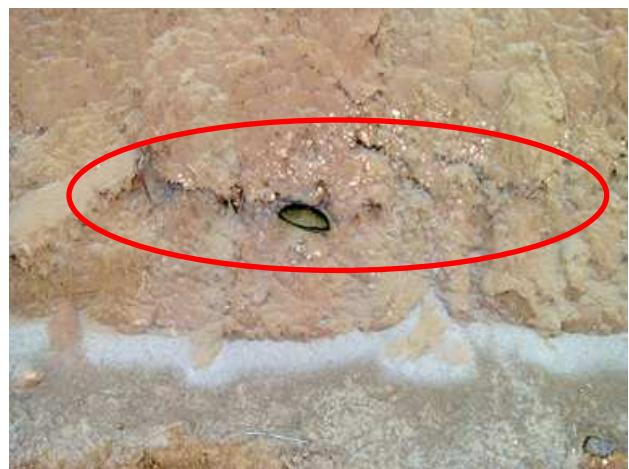
Figura 5. Camada de concreção de limonita no pé do talude
