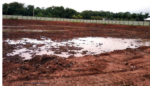
Figura 2. Situação antes do rebaixamento.
