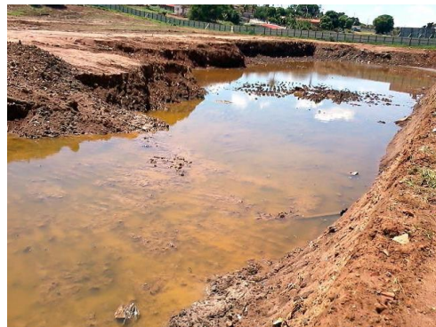
Figura 1. Situação antes do rebaixamento.
