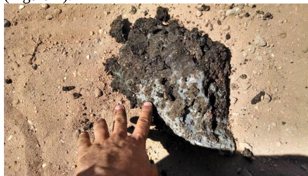
Figura 3: Bloco com grande concentração de cimento obtido em escavação de poço de visita.
