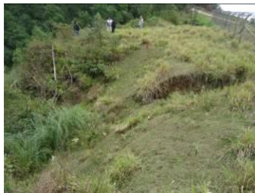
Figura 2. Erosão localizada a montante do reservatório
