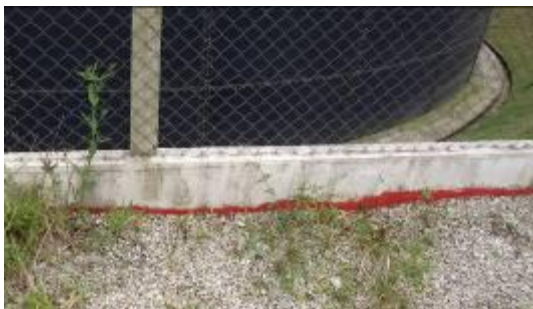
Figura 4. Marcação (em vermelho) para se observar os deslocamentos verticais causados pela movimentação do aterro.
