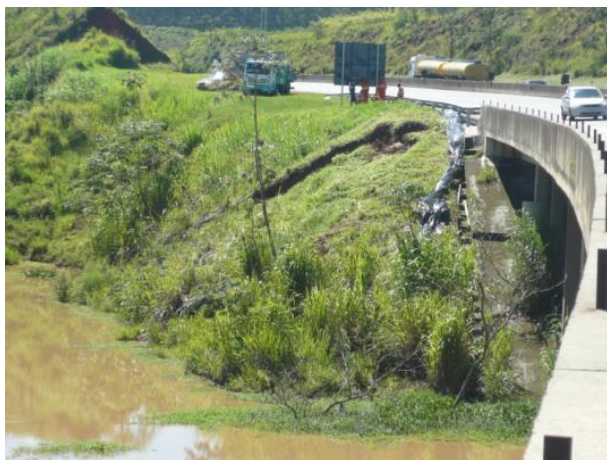
Figura 1: Vista da ruptura, a partir do encontro oposto da ponte.
