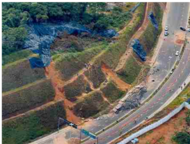
Figura 16. Foto do deslizamento.
