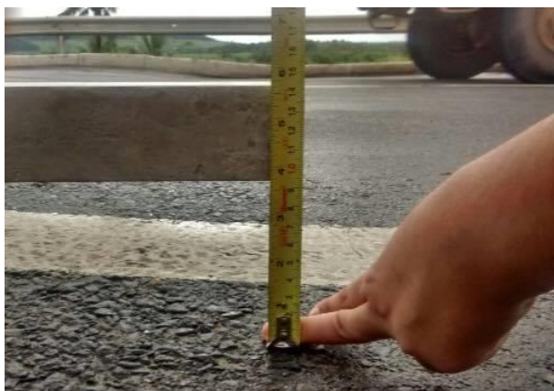
Figura 4. Desnível existente no pavimento da BR, cerca de 10 centímetros. Fonte: Produzida.
