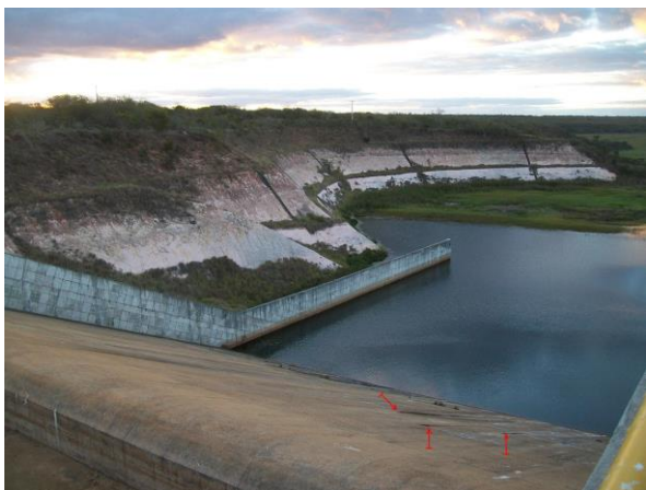
Figura 15. Detalhe da rampa do vertedouro, onde as setas vermelhas indicam pontos de fuga de água, através do concreto, indicando que ocorre acúmulo de água abaixo da rampa.
