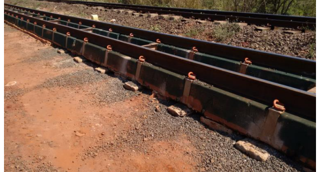
Figura 03. Reforço emergencial realizado na plataforma devido a desnivelamento excessivo.
