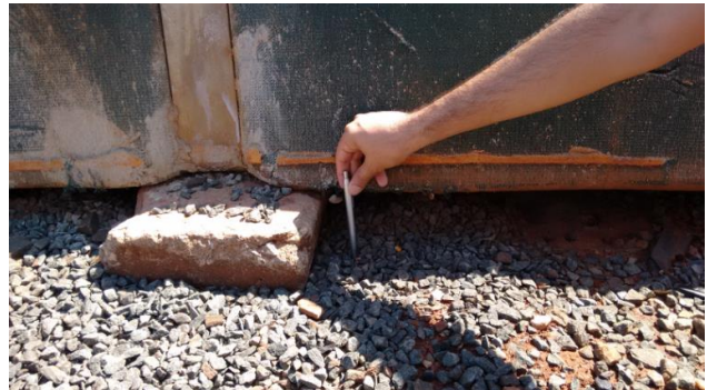
Figura 04. Falta de contato do tubular track com o subleito.
