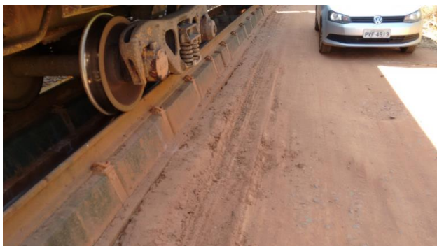
Figura 06. Falta da declividade na plataforma o que dificulta drenagem e satura o solo.
